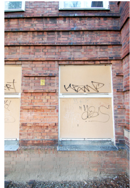
Verriegelung der Fensterflächen im EG
