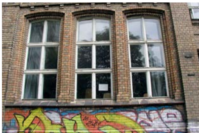
Unsanierete Fassaden- und Fensterflächen
